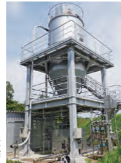
ドライ粉末活性炭注入設備
