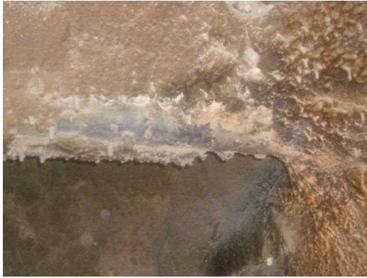
写真1 ヘッダー管の耐火被覆脱離状況
